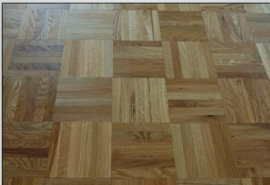
Abb. 9 Gleicher Fußboden wie in Fehlerbild 3, allerdings in Premium-Qualität
